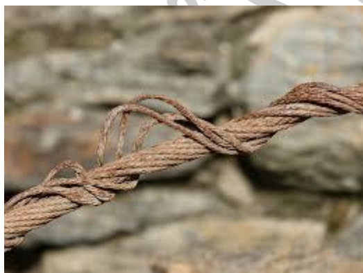
Figuur 6: Voorbeeld van ernstig beschadigde en gecorrodeerde staalkabel.
